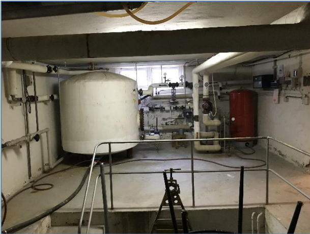
Foto 1: Varmecentral i sin helhed
