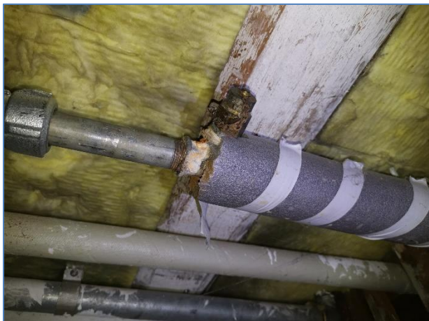
Foto 1: Vandrør med korrosion i kælder
