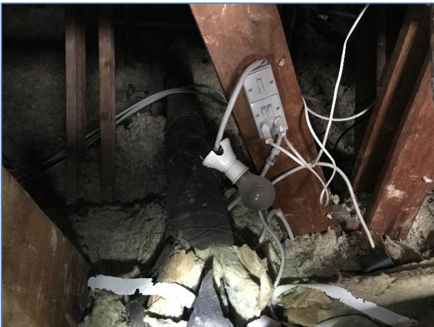
Foto 3: El-installation på loft
