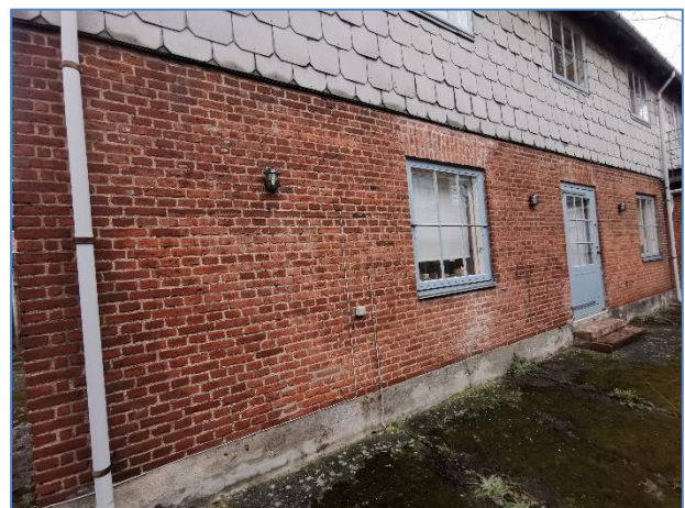
Foto 6: Nedløbsrør på lejemål
