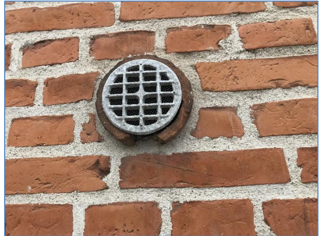
Foto 2: Aftrækskanal fra bolig
