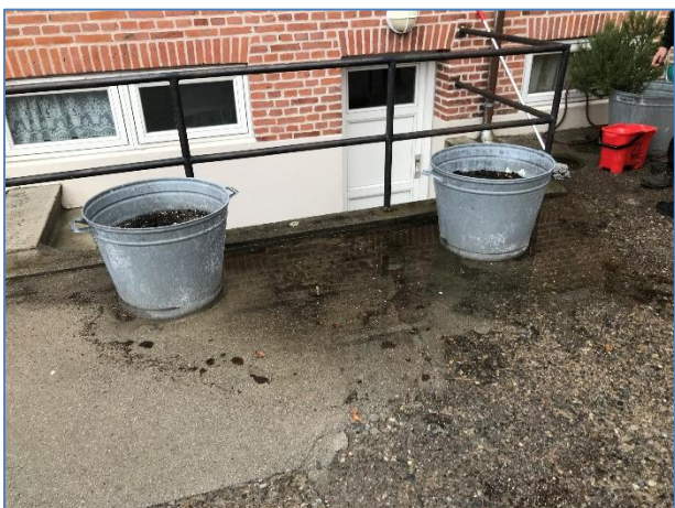
Foto 3: Opkant ved kældertrappe
