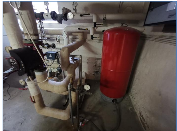
Foto 4: Højre side af varmecentral
