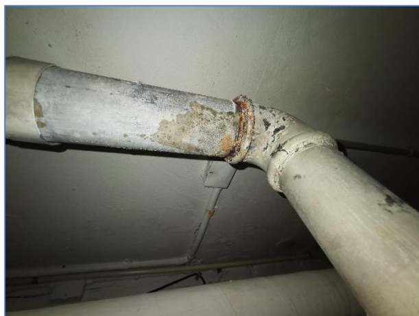
Foto 4: Utætheder på vandinstallationer
