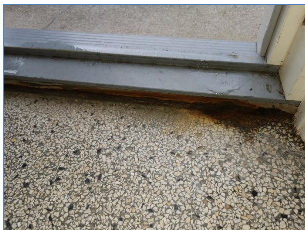
Foto 4: Dørtrin ved opgangsdør
