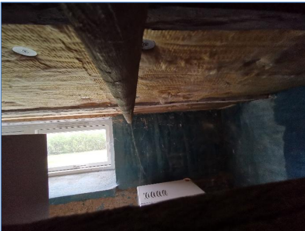
Foto 3: Loft i kælder
