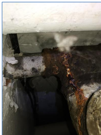
Foto 2: Fordelingsledninger i kælder
